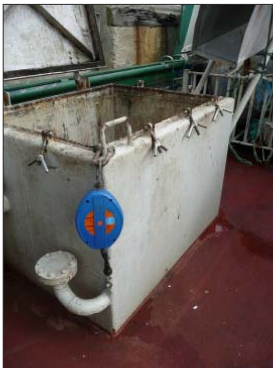
Nedgang til lasttank med faldtalje monteret
