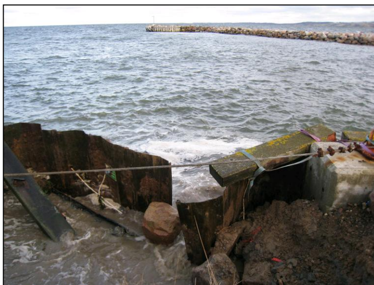
Skaden på kajanlægget
