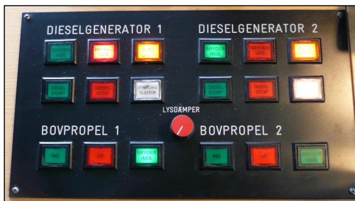
Panel til indkobling af generatorer og bovthrustere
